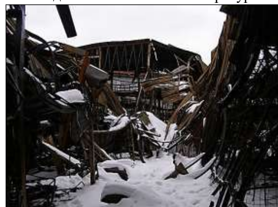
Рис. 2. Состояние кровли здания после воздействия высокой температуры
