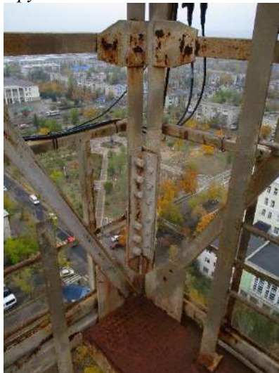
Рис. 3. Корозійний знос елементів несучої вежі понад 10%.
