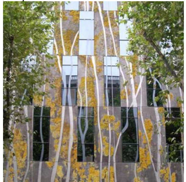
Рис. 10. Фасад из биологического бетона.
