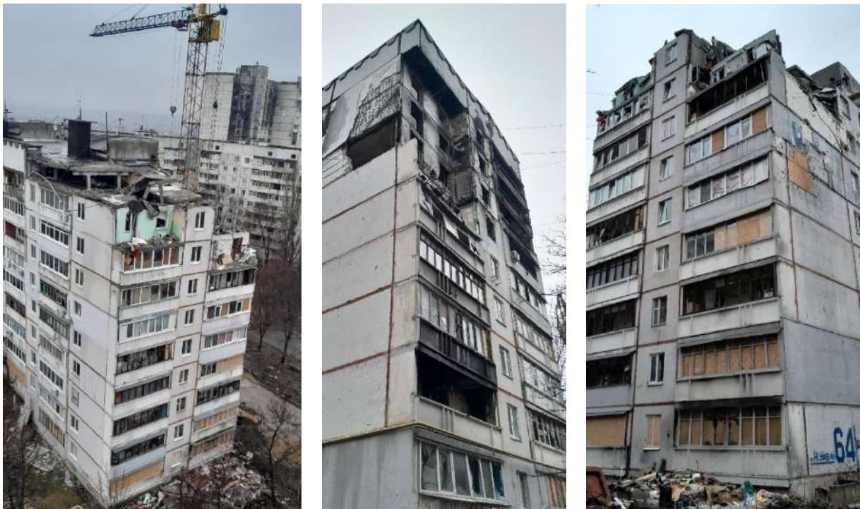
Рис. 2. Багатоповерховий будинок по вул. Н. Ужвій, 64 в м. Харкові після отриманих руйнувань
