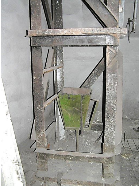
Рис. 5. Узел опирания металлической сквозной опоры под трубу №3 секционной печи №4. Элемент решетки вырезан.
