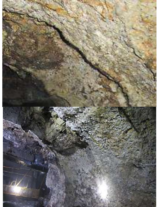
Рис. 2. Внутренняя поверхность канализационных тоннелей, разрушенная коррозией
