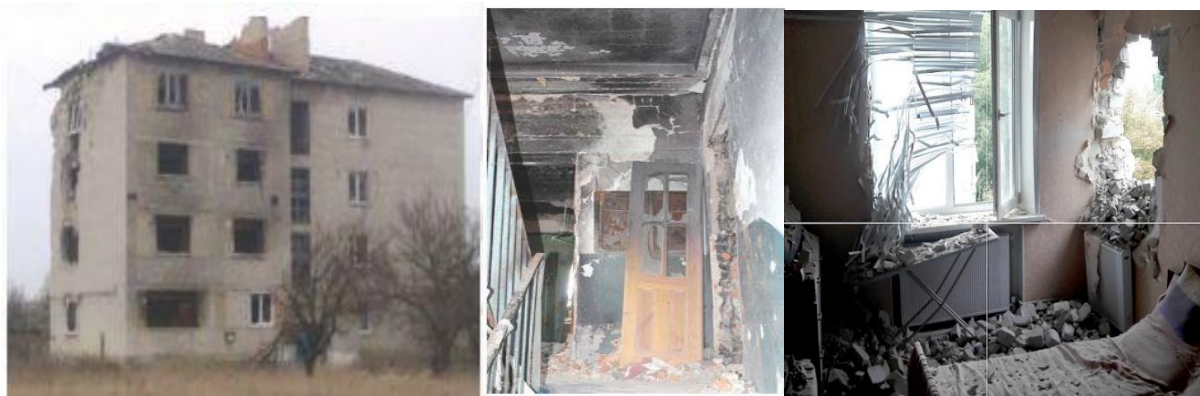
Рис. 1. Пошкоджені будівлі (зокрема, будівля на вулиці Петровського а, б) у звільненому м. Мар'їнка [9, 10].
