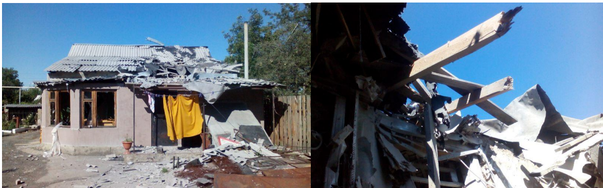
Рис. 3. Руйнування житлового сектору в звільненому м. Авдіївка [14].
